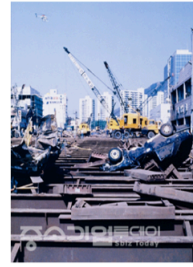
대구 지하철 공사장 사고 현장.
